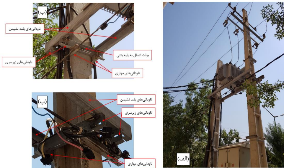
شکل ۲. پست هوایی ۳۱۵ kVA مورد مطالعه؛ الف) نمای کلی؛ ب) جزئیات اتصال به پایه ۹ m؛ پ) جزئیات اتصال به پایه ۱۲ m
