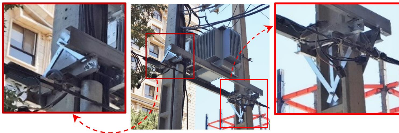
شکل ۱۸. نمای جنوب شرقی پست هوایی مقاوم سازی شده
