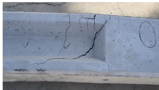
شکل ۱۵. مود گسیختگی پایه بتنی شماره ۱ تحت اثر نیروی کشش نهایی
