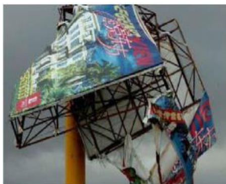
(ب) خرابی در سازه نگهدارنده بیلبورد
