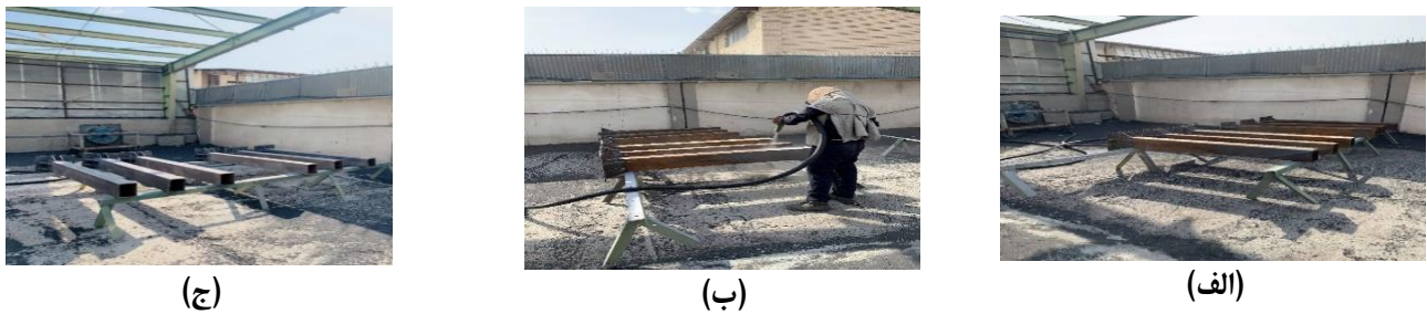
شکل ۵. فرآیند سندبلاست (الف) محل سندبلاست و آماده‌سازی نمونه‌ها، (ب) سندبلاست محل نقص نمونه‌ها، (ج) نمونه‌ای از ستون‌ها بعد از انجام عملیات سندبلاست
