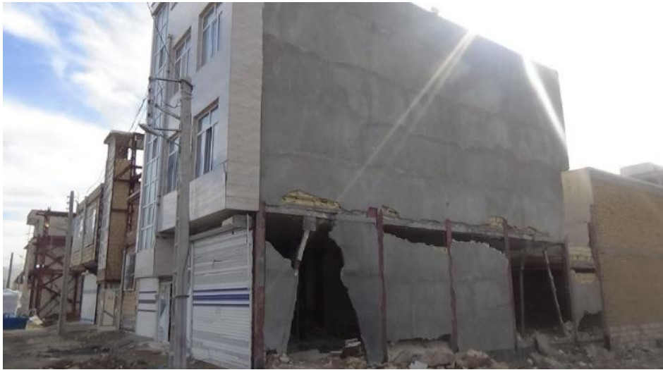
شکل ۱. ساختمان سه طبقه آسیب دیده در زلزله سرپل ذهاب با سیستم مهاربند برون محور (نگارندگان)
