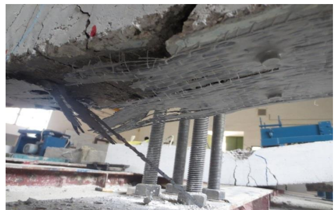
شکل ۱۰. نحوه گسیختگی تیر B1-b Fig. 10. FRP Rupture at Sample B1-b
