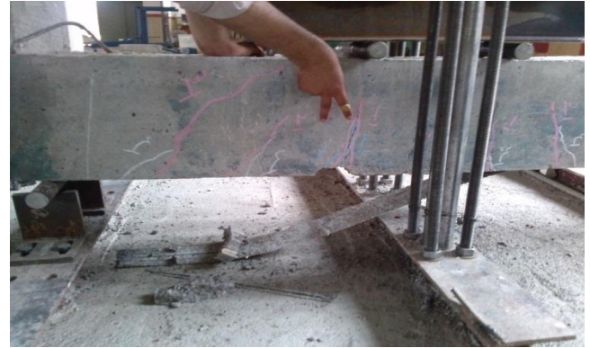
شکل ۷. جدشدگی ورق تقویت تیر B2 Fig. 7. FRP De-bonding at Sample B2
