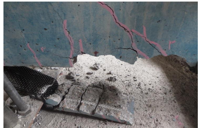
شکل ۱۳. نحوه گسیختگی تقویت در تیر B3-bUS Fig. 13. Rupture of FRP Sheet at Sample B3-bUS
