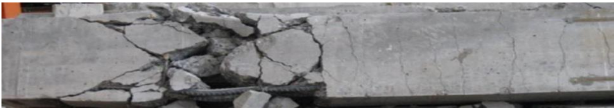
شکل ۱۷. مدل شکست X شکل بین تکیه‌گاه و محل اعمال بار در تیر بتنی آزمایشگاهی و نشانگر شکست برشی در بارگذاری چرخه‌ای [۷] Fig. 17. X-shaped shear fracture of the beam between support and loading point in experiment
