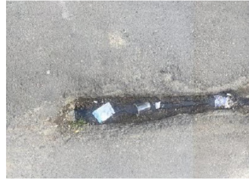
الف) سطح روسازی دارای خرابی چاله
