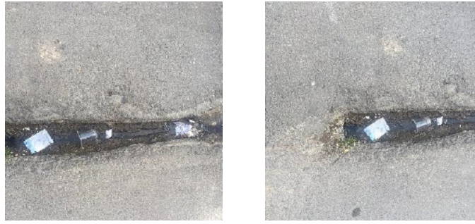
الف) سطح روسازی دارای خرابی چاله
