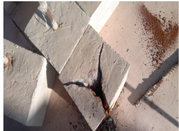
شکل ۱۲: نمونه آزمایشگاهی ترک خورده ناشی از خوردگی آرماتور در بتن (آرماتور در وسط)
