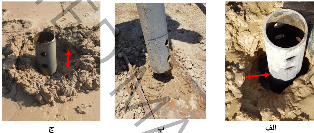
شکل ۱۲: بررسی کیفی اثر فشار آب در اجرا الف) خالی شدن اطراف شفت به دلیل فشار آب زیاد ب) پر شدن شفت مرکزی توسط گل ج) نشست خاک مناسب خاک در فشار آب ۴ بار
