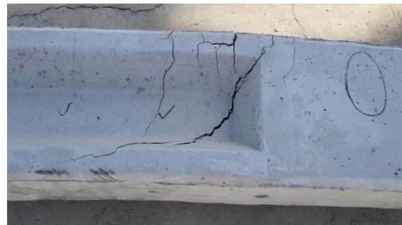
شکل ۱۵. مود گسیختگی پایه بتنی شماره ۱ تحت اثر نیروی کشش نهایی
