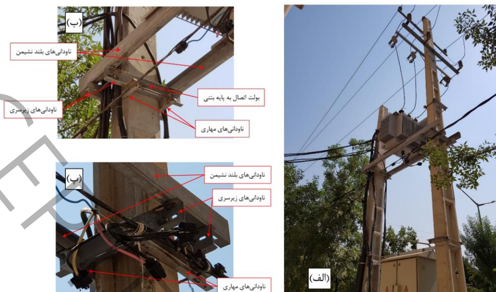
شکل ۲. پست هوایی ۳۱۵ kVA مورد مطالعه؛ الف) نمای کلی؛ ب) جزئیات اتصال به پایه ۹m؛ پ) جزئیات اتصال به پایه ۱۲m
