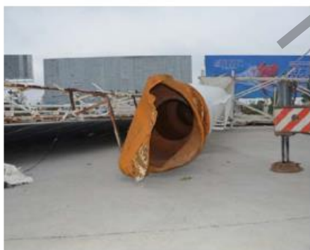
(د) گسیختگی پای ستون فولادی
