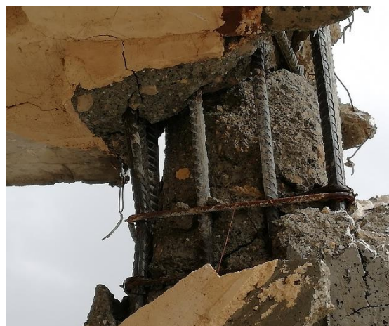
ث) تخریب کامل بالای ستون و چشمه اتصال e. Complete destruction of concrete core and joint at top of the column
