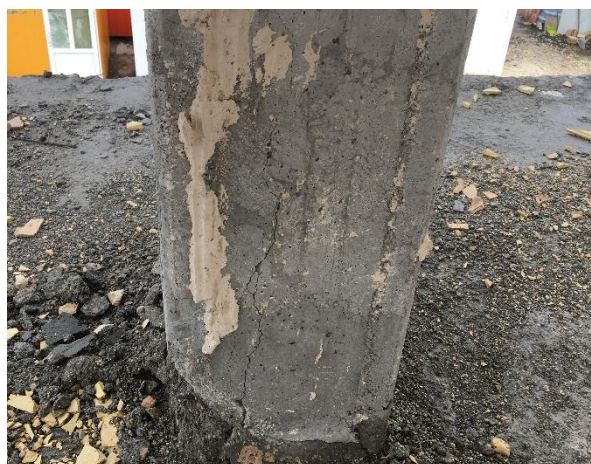
ج) ایجاد ترک قائم در ستون f. Vertical crack formation in a column
