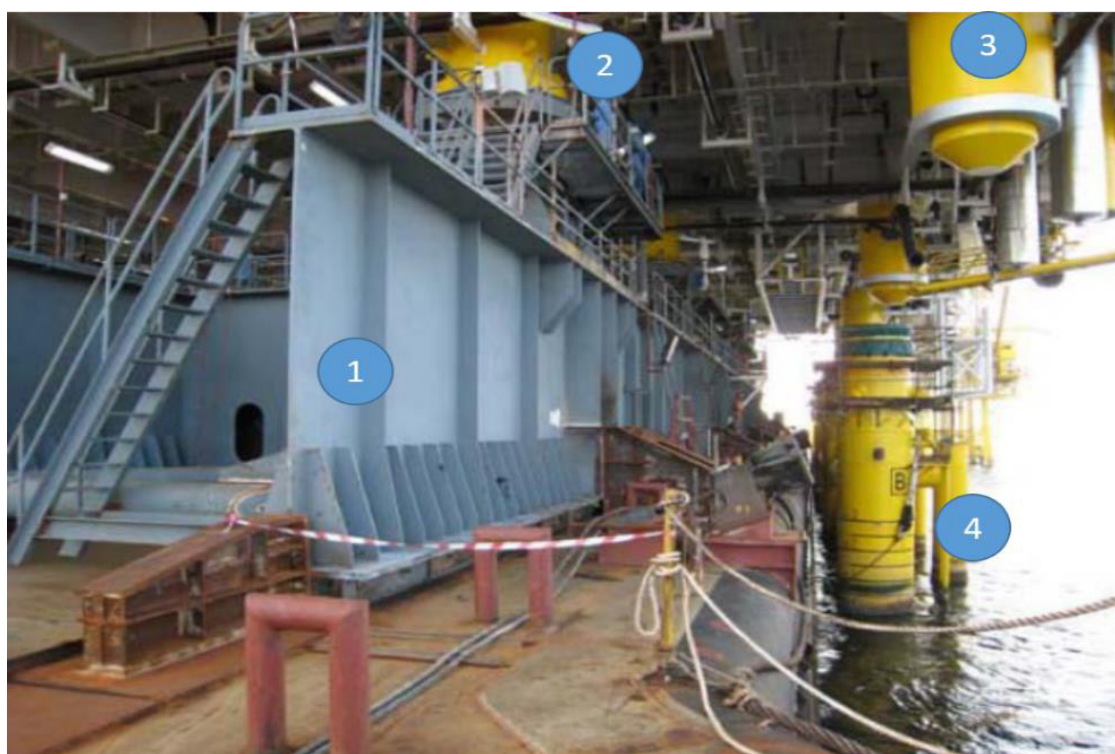
شکل ۱. المان‌های مورد استفاده در نصب فلوت‌اور، (۱) سازه نگهدارنده عرشه، (۲) المان نگهدارنده عرشه، (۳) المان میتینگ، (۴) پایه‌های جکت [۲۰]
