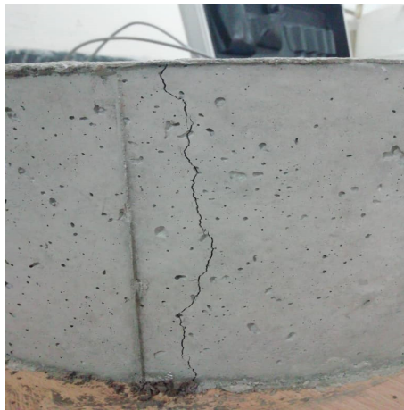
شکل ۹. نمونه‌ای از تصاویر تهیه شده به منظور تعیین عرض ترک (بتن شاهد در سن ۶۰ روز) Fig. 9. Image of OPC Concrete in order to evaluate Crack width
