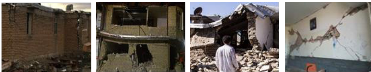
شکل ۱. خسارت دیوارهای مصالح بنایی غیر مسلح در زلزله ۲۱ آبان ماه کرمانشاه ۱۳۹۶ Fig. 1. Damages of unreinforced masonry walls, earthquake Kermanshah 2 November 2017.
