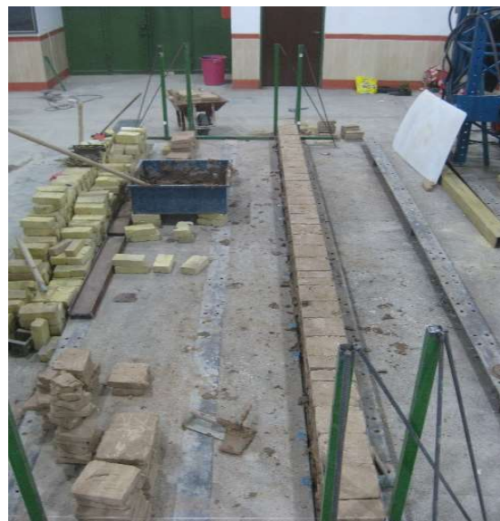
شکل ۴. سکوی طولی جهت ساخت هم زمان نمونه ها Fig. 4. Wall making platform
